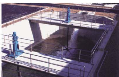
上水道设备 - 饮用供水系统
